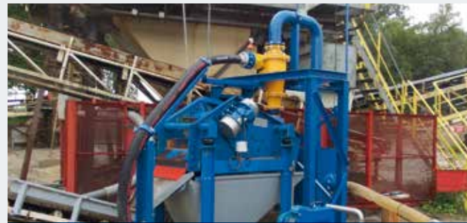
Zyklon im Einsatz zur Sandrückgewinnung aus Abwasser (aus Förderbandreinigung) 80 m 3 /h, 3 – 5 t/h, Trennschnitt bei ca. 0,063 mm
