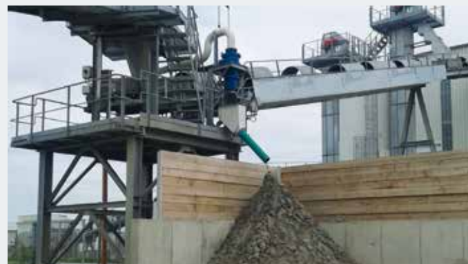
Zyklon im Einsatz zur Sandrückgewinnung aus Abwasser (aus Schwertwäsche) 80 m 3 /h, für Sand 0 – 4 mm, ca. 5 – 15 t/h, Trennschnitt ca. 0,063 mm
